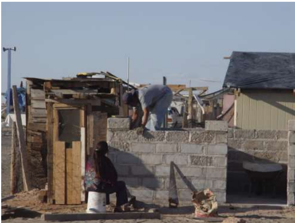
La autoconstrucción de vivienda es otra alternativa de los vecinos de la colonia Nuevo Peñasco.
